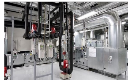
ビルオートメーション
